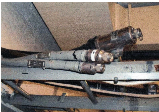
Överst kabeln till luformasten på andra sidan riksväg 40. De två grå kablarna gick till RL-02 antenner (senare RL-031) för länk till Ls E på Tislarna. Länkar fanns även till Ls A Nidingen och Ls T Hamneskär (Pater Noster), men dessa länkhopp utgick från en mellanstation.
